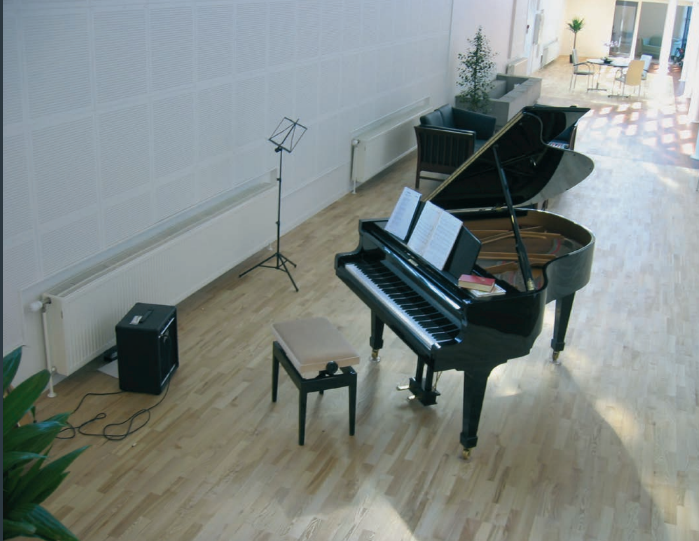
Panelradiatorer i Aula
